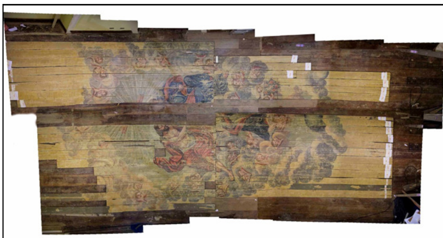
Figura 8: Aspecto do conjunto de tábuas do forro da capela-mor encontradas durante o restauro arquitetônico. Foto: Júlio Moraes, 2007.
